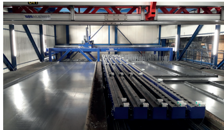
Nach der Modernisierung: Einschalanlage mit neuen Taktrollenbahnen und neuem Weckenmann-Magazinierer
