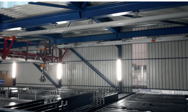
Vor dem Retrofit-Projekt: Einschalanlage bei ABI Bedburg
