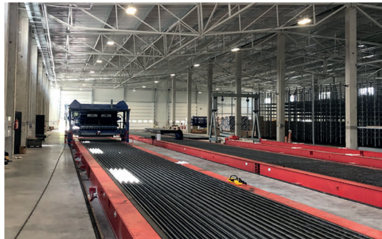
Vista del interior de la nave de fabricación de Mszczonów en Polonia
