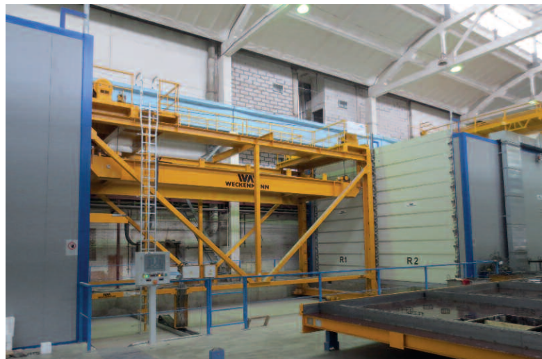
Камеры тепловлажностной обработки с воздушным подогревом
