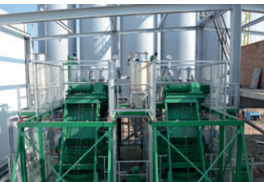
La instalación mezcladora necesaria para la nueva fábrica fue suministrada por Teka
