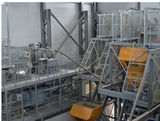
A completa instalação de mistura de concreto é composta por cinco estações de mistura lado a lado, totalmente autônomas e independentes.
