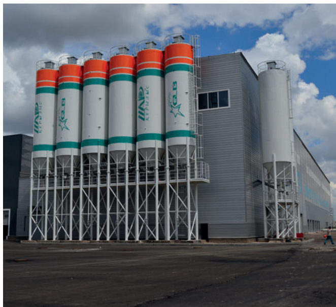
A Teka Maschinenbau GmbH foi encarregada do fornecimento e da criação da instalação de mistura de concreto.
