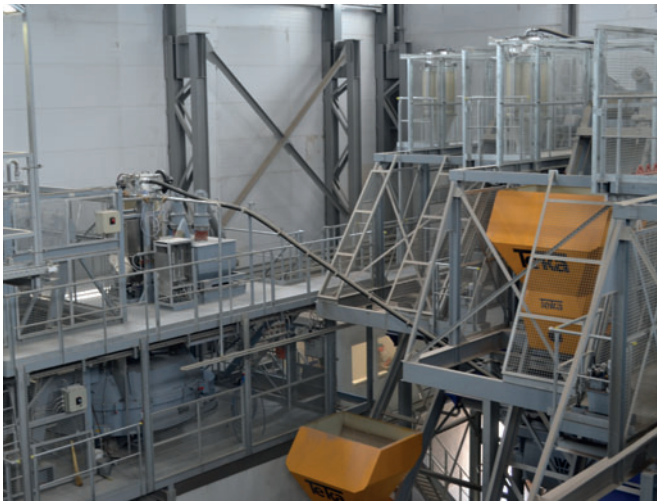
La instalación mezcladora de hormigón completa está compuesta por cinco estaciones de mezcla completamente independientes ubicadas una junto a la otra.
