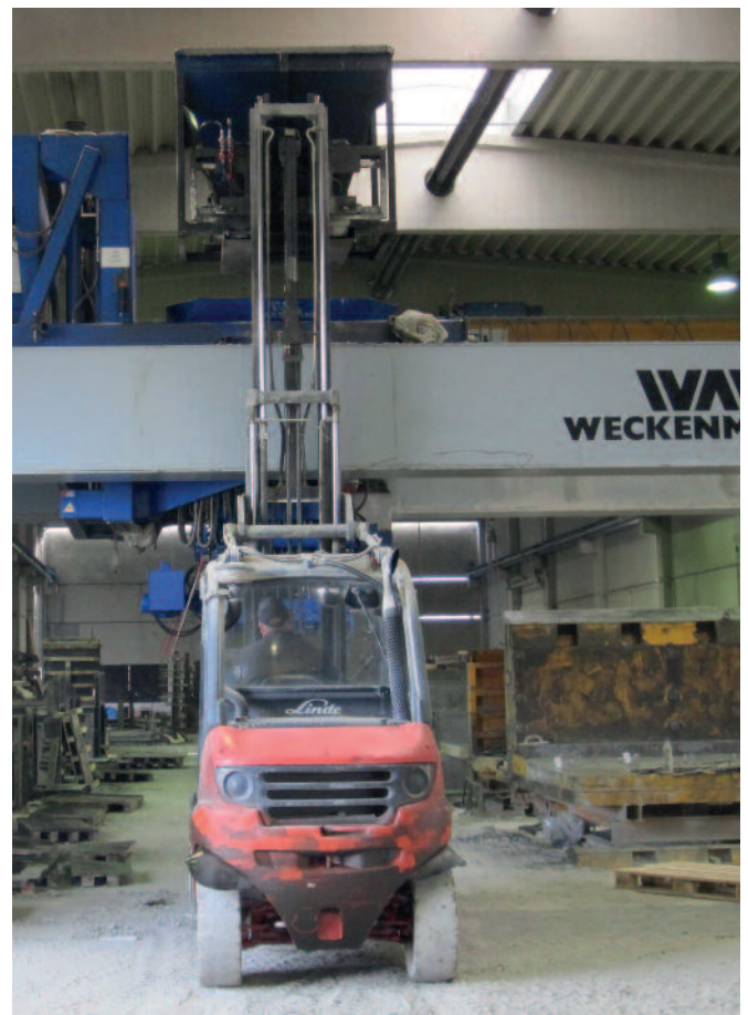
A caçamba do distribuidor de concreto ainda é preenchida com a empilhadeira; no futuro o concreto será abastecido diretamente no distribuidor de concreto por meio de uma linha lateral da nova instalação de mistura, que já esta em planejamento
